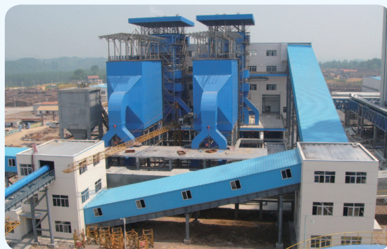
» 骏泰浆纸生物质锅炉
